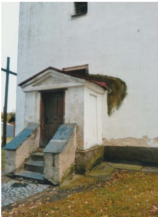
Schäden am Turm-Eingang
