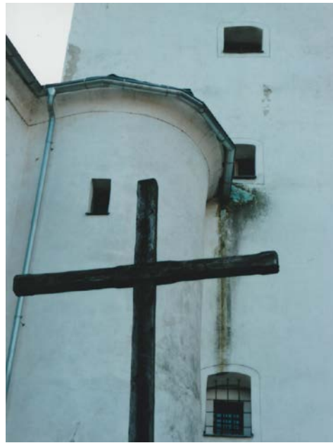
Schäden an der Dachrinne am Turm
