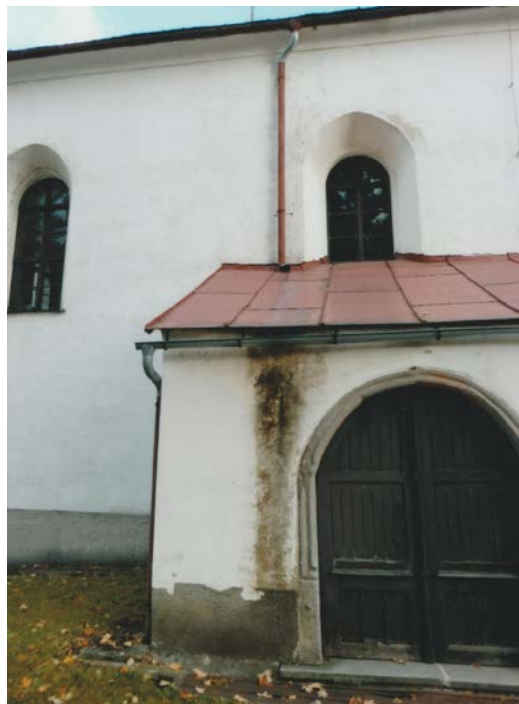
Schäden am Eingang vom Friedhof
